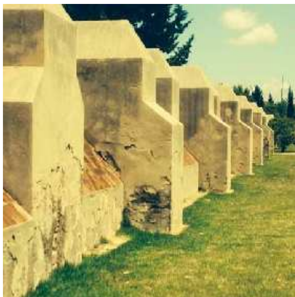
Muro de contención de avenidas del Monasterio de La Cartuja (J. M. Fernández-Palacios, mayo 2016)
