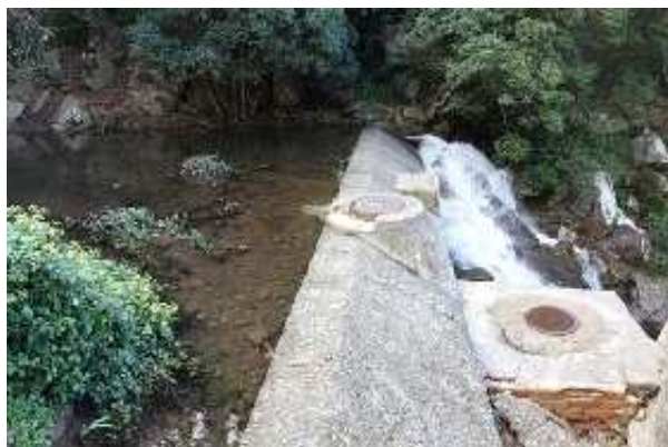
Toma de agua del río los Molinos (M. Limón Andamoyo, abril 2022)
