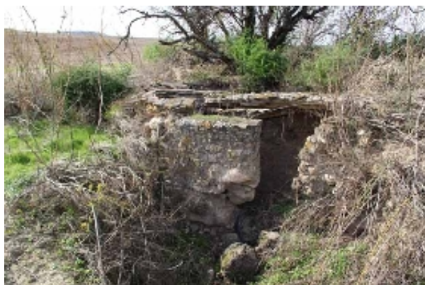
Imagen frontal donde se aprecia la rotura del brocal (J. Sancho Pérez, noviembre 2020)
