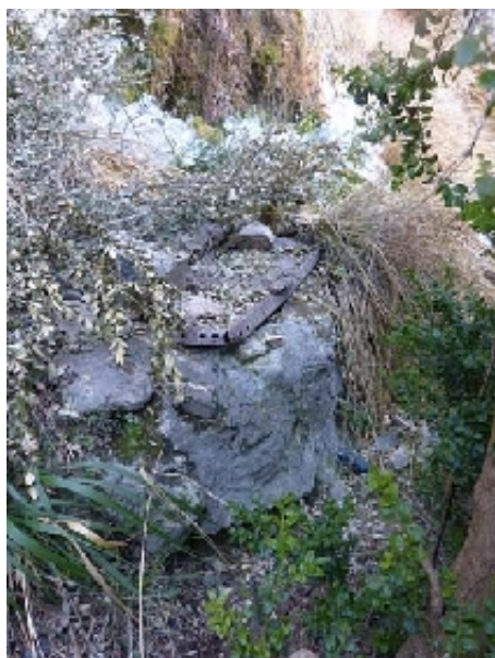
Fuente de la Cascada de la Escaleruela, arqueta (J. D. Cano Cavanillas, enero 2015)
