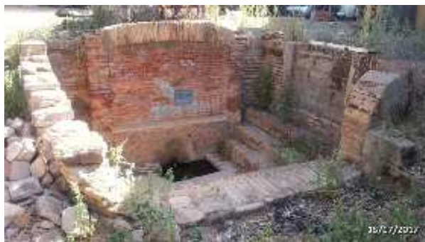
Vista Frontal de la fuente, con algunos ladrillos laterales de la pared izquierda ya caídos (A. Ventas, julio 2017)
