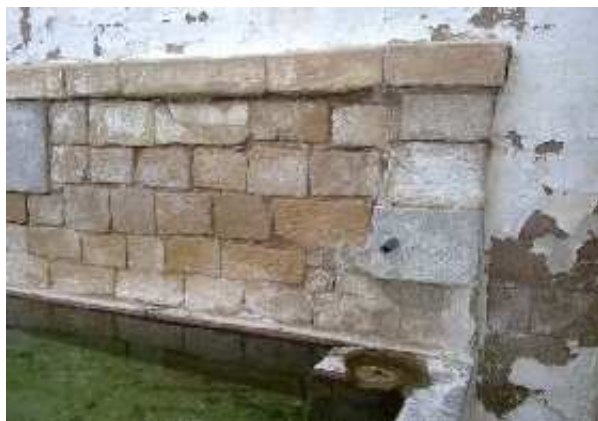
Pilar de la Carrera Alta, detalle del ca o de agua no potable (R. Quesada, junio 2010))
