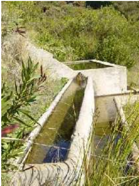
Fuente Janón, vista general, con detalle del pilar y depósito (A.J. Peña Toro, diciembre 2007)
