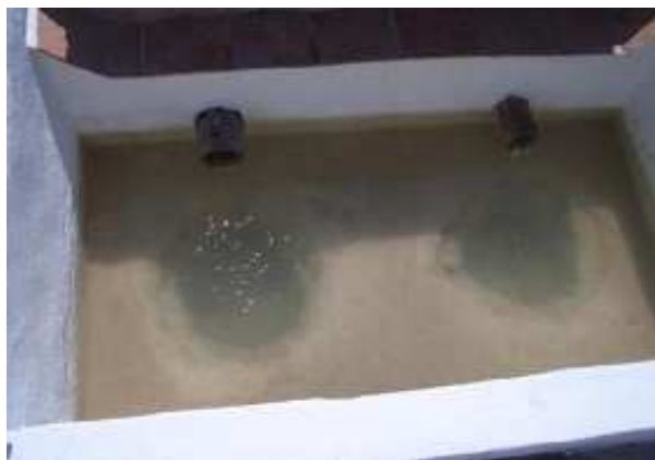
Detalle de la decantación del agua
