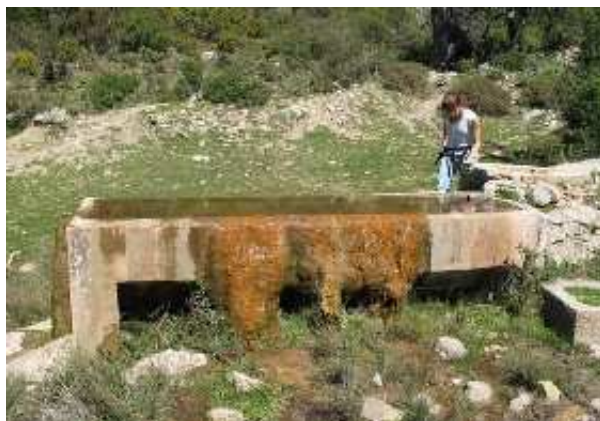
Vista del pilar y de los travertinos en formación (J. del Val Melús, marzo 2009)
