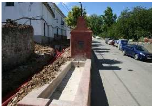
La Fuente de Puerto Moral, en estado de remodelación (J.L. Macías Rico, abril 2009)
