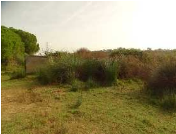
Vista de la caseta de bombeo y pozo oculto entre las zarzas, los juncos y las eneas (J. F. Martín Álvarez, OCTUBRE 2024)
