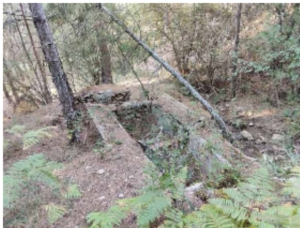
Vista general del lavadero del cortijo del Cerro Mirandante (D. Sánchez Garrido, octubre 2020)
