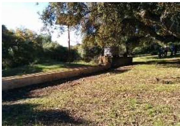
Pozo, pilar y poste con panel fotovoltaico (R. Velasco Riejos, abril 2019)
