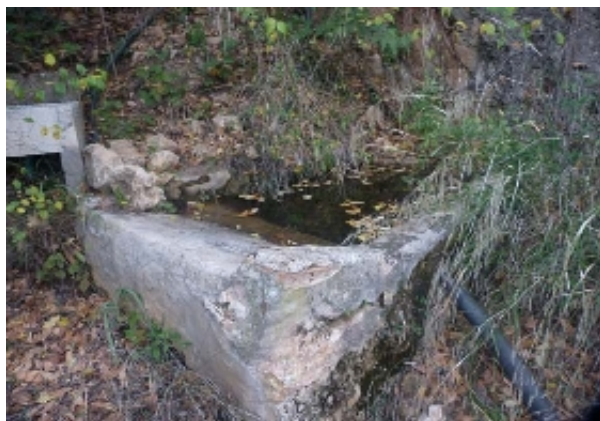
Fuente del cortijo del Civil (L. Cano Cavanillas, noviembre 2015)
